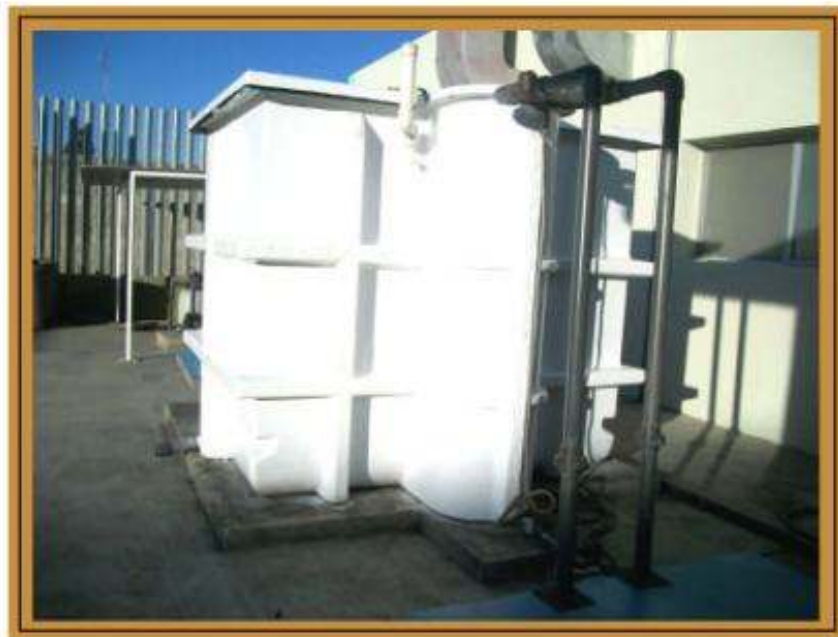
Planta de Tratamiento de Aguas Residuales
